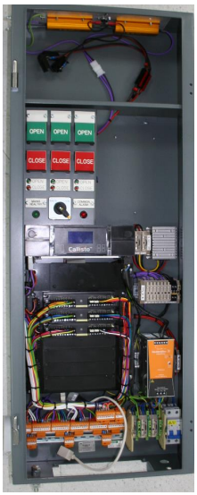
11kV RMU RTU (3 Switch)
