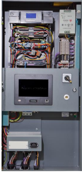
11kV RMU RTU (1-4 Switch)
